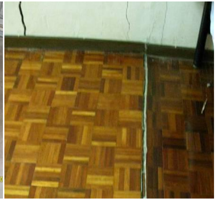
Retak besar (21.1mm lebar) pada lantai di bilik 2 Rumah 19
