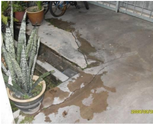
Retak sederhana (5.0mm lebar) pada lantai kaki lima di anjung Rumah 3
