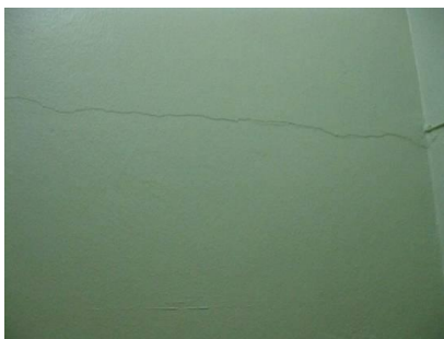
Retak sangat kecil (0.5mm lebar) pada dinding di tandas 3 Rumah 16
