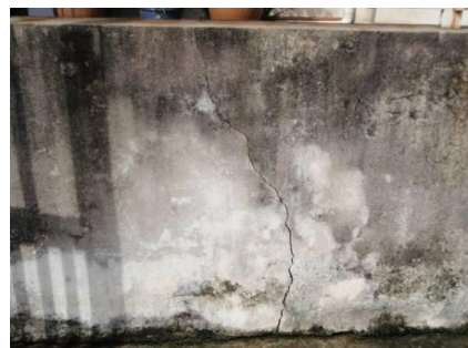
Retak kecil (3.0mm lebar) pada dinding tembok di anjung Rumah 8
