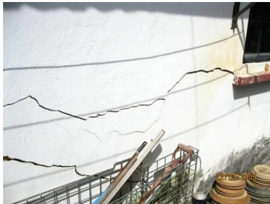
Retak sangat besar (37.9mm lebar) pada dinding di bilik utiliti Rumah 13
